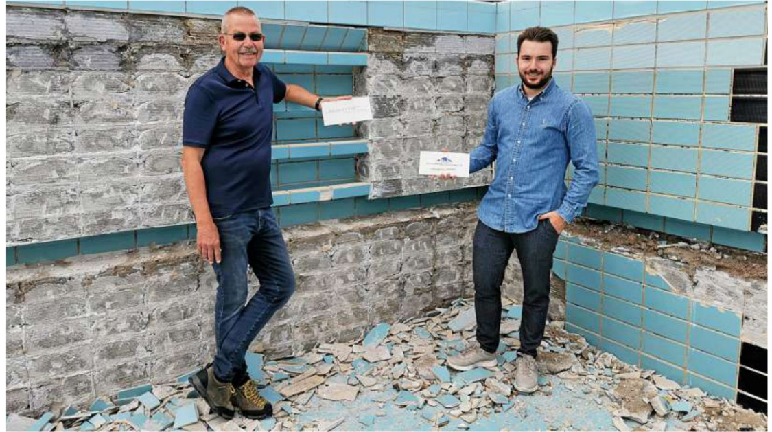
Ralf Brinkschulte (li.) und Peter Zimmermann freuen sich, dass es bei der Sanierung des Heidebads losgeht. Sie suchen noch finanzielle Unterstützung.
